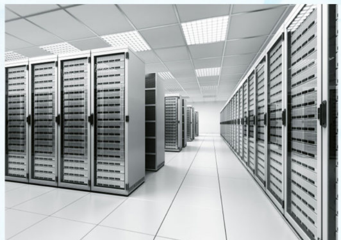
· Data Center Room ·
