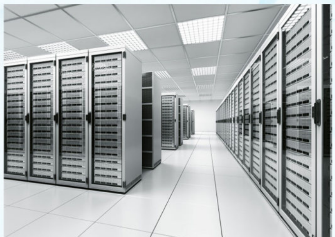
· Data Center Room ·
